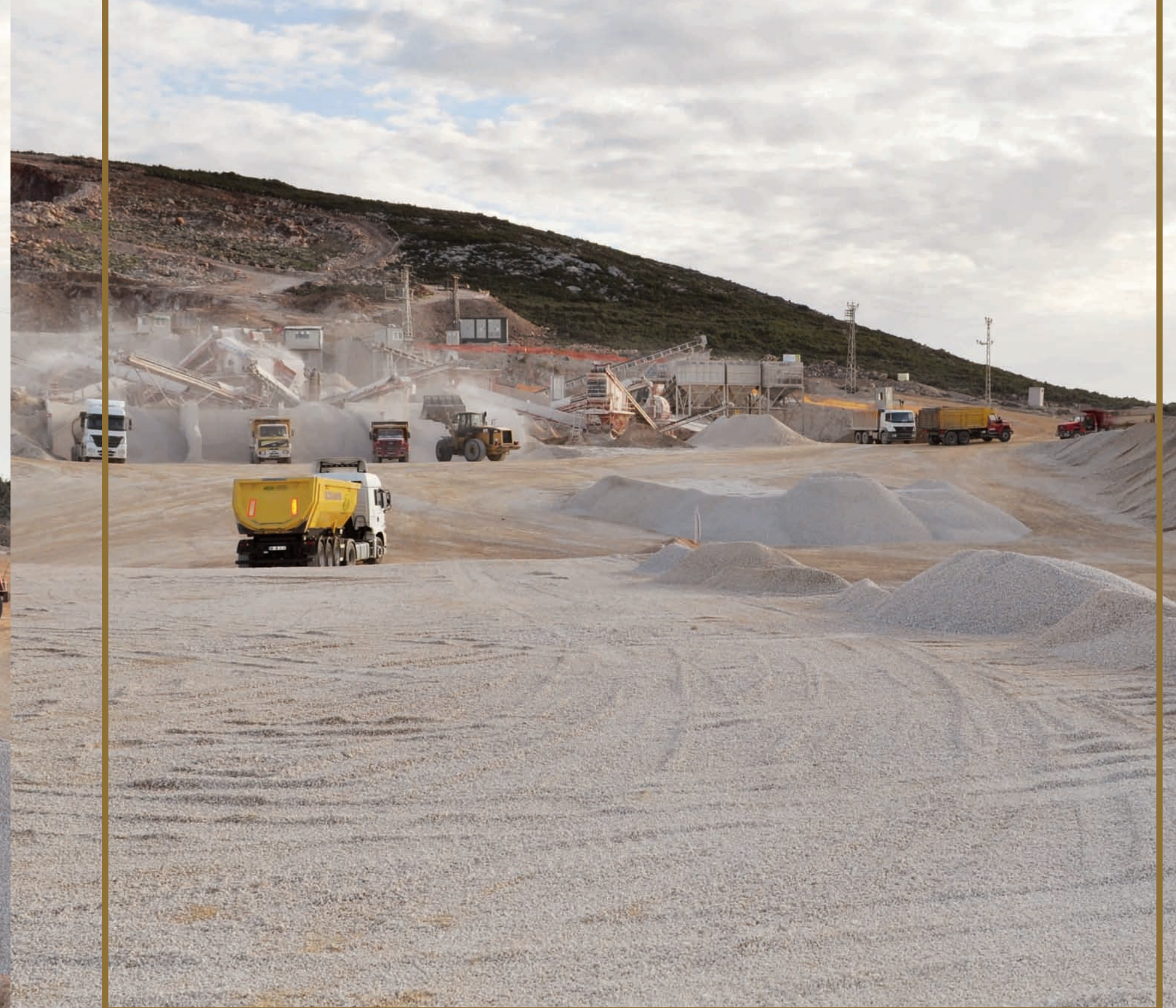
Bandırma, Edincik'teki Agrega Kırma Eleme Tesisimiz
