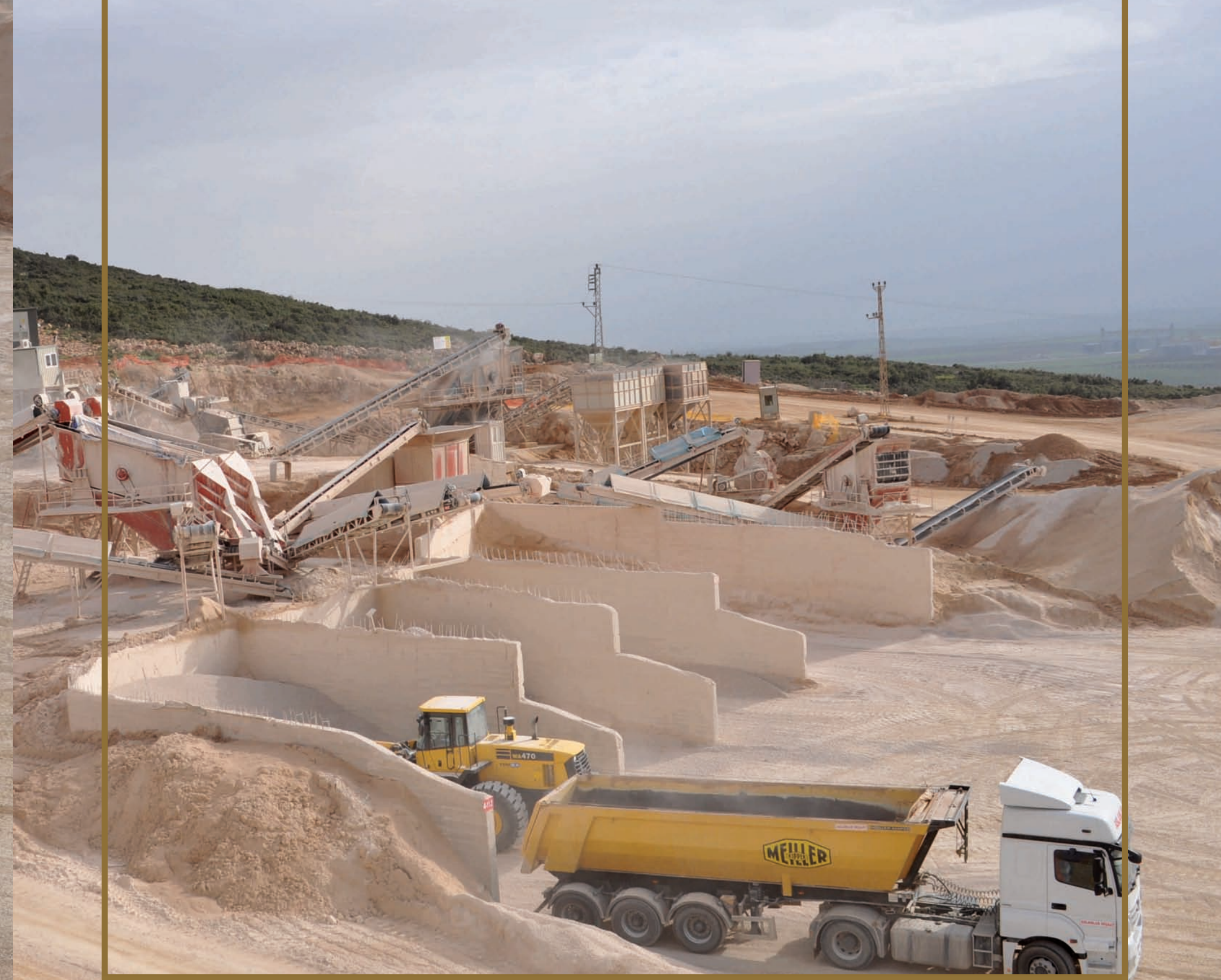
Bandırma, Edincik'teki Agrega Kırma Eleme Tesisimiz
